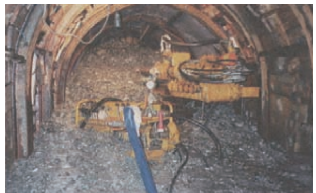
写真-2 切羽の崩壊
