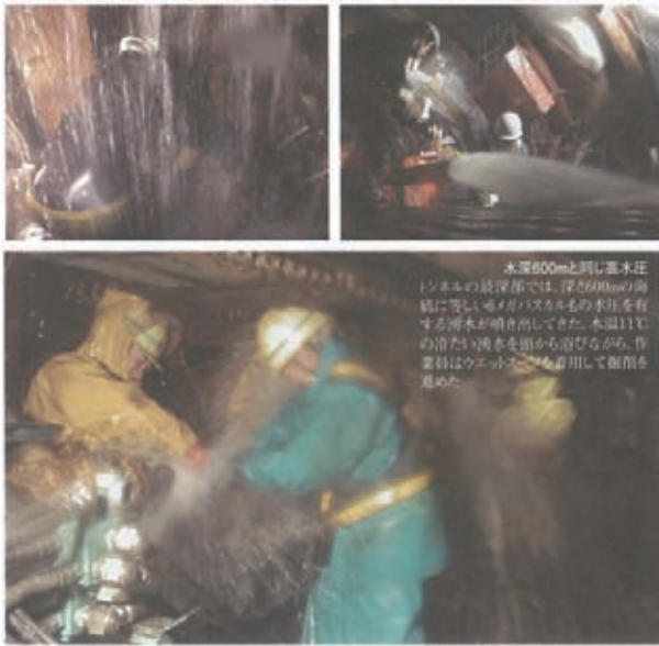
写真-3 高圧・大量湧水
