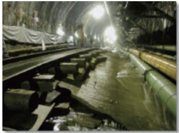
写真-1 盤ぶくれ状況(NEXCO中日本HPより転載)
