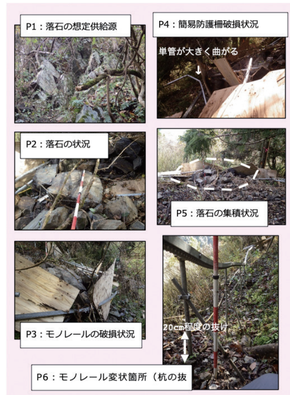
図-5.2 落石・モノレール等破損状況写真
