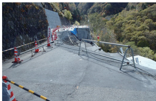
路側崩壊状況
