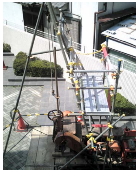
写真-2 安全檣運用状況
