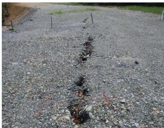
写真-1 発生した亀裂
