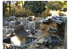
本光寺の崩れた土塀
