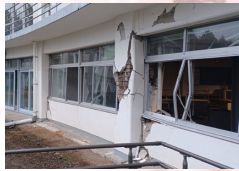
被災した旧 1 号館建物
