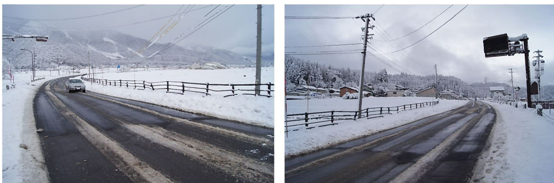
断層横断個所の状況 (12月5-6日調査)
