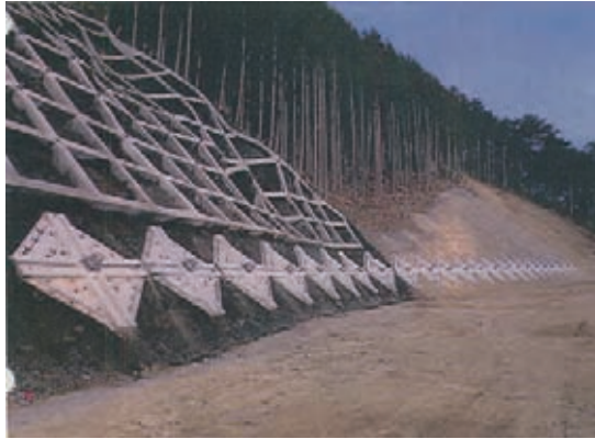
図-49 被災前のアンカー状況 (三重県松阪農林商工環境事務所提供)
