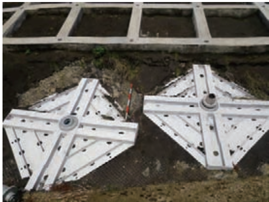
図-51 アンカーの変状状況
