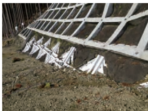
図-33 アンカー変状・埋没の状況
