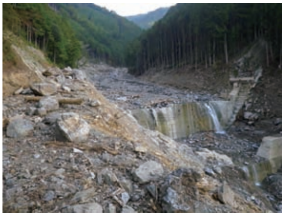
図 -47 治山堰堤の被災状況
