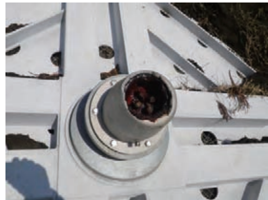
図-54 頭部キャップが破損した A-2 アンカー
