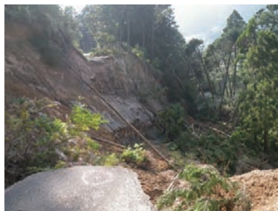
図-14 地すべり的な崩壊状況
