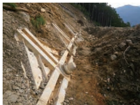
図-34 掘起こし後の埋没アンカー状況
