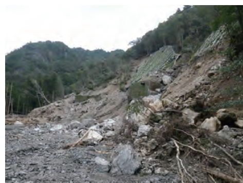
図-26 林道および法面等の被災状況
