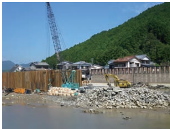
図-8 輪中堤の決壊状況と緊急対策
