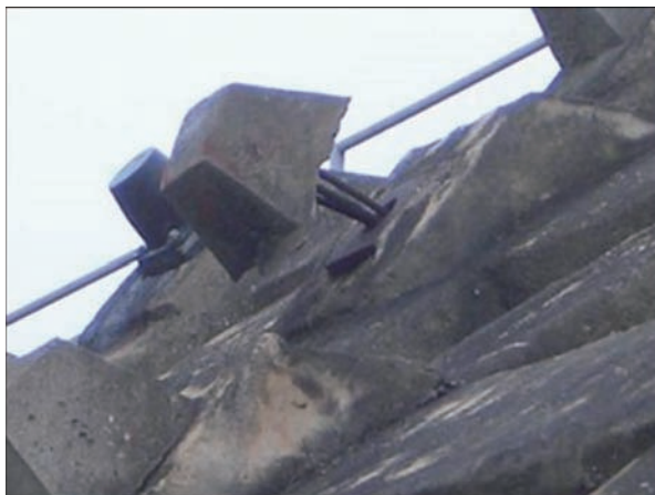
図-5.2 アンカー頭部の飛び出し
