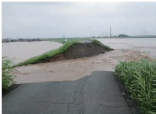
写真-1 矢部川で発生した越水なき破堤 1)
