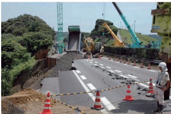
図-1.1 平成21年駿河湾を震源とする地震による東名高速道路の盛土崩壊 1)
