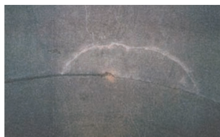
(a) 天端付近の半月状のひび割れ
