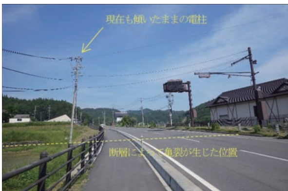
写真-2 神城断層によって傾いた電柱と周辺道路
