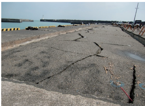
写真-9 2009.相良港の変状
