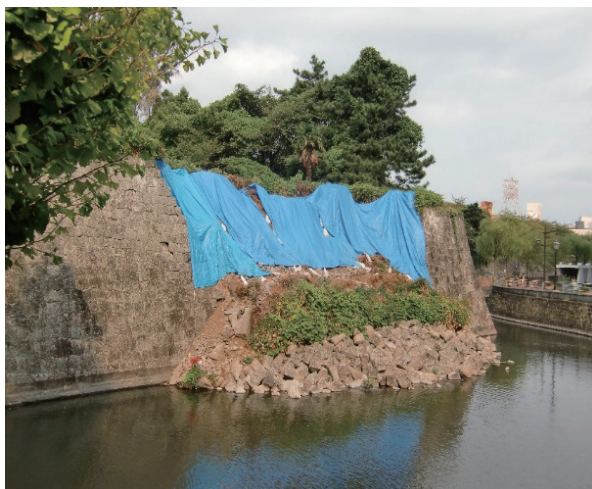
写真-8 2009.8駿府城石垣の崩壊
