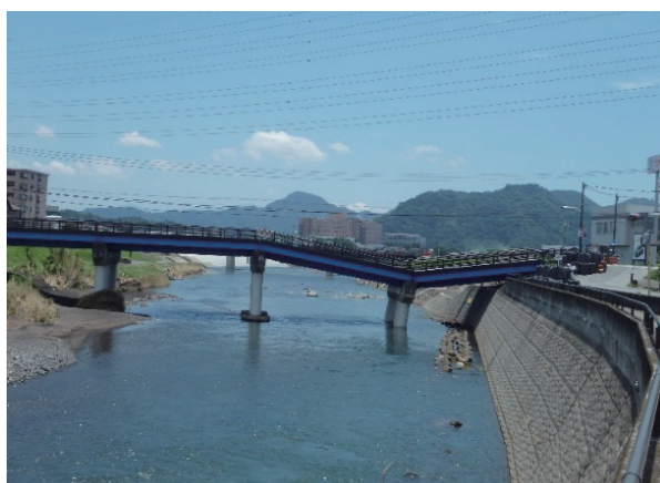
写真-5 2021.7黄瀬川大橋の橋脚洗掘による崩落災害
