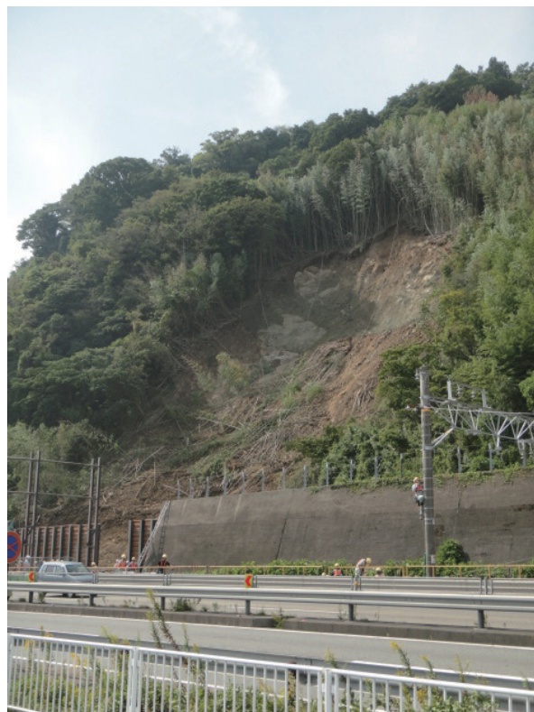
写真-10 2014.10JR東海本線山側斜面の崩壊 (手前は国道1号)
