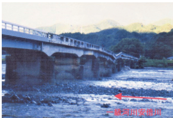
写真-3 安倍川電西橋の崩落 4)
