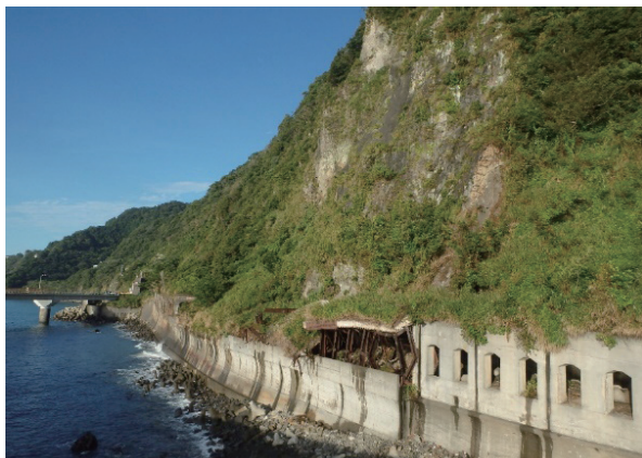
写真-1 現在も残される被災現場
