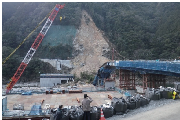
写真-6 2015.1原田橋の崩落事故
