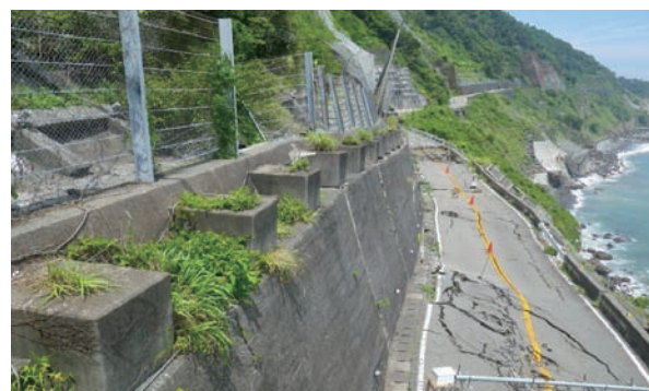
写真-2 被災直後の道路
