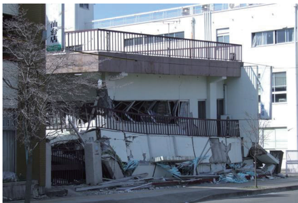
写真-1 平成23年(2011年)東北地方太平洋沖地震の地震動で倒壊した建物(宮城県内 撮影：応用地質(株))
